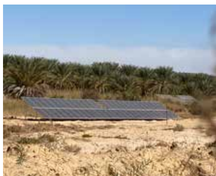
L'exploitation a remplacé les groupes électrogènes par des panneaux solaires.
